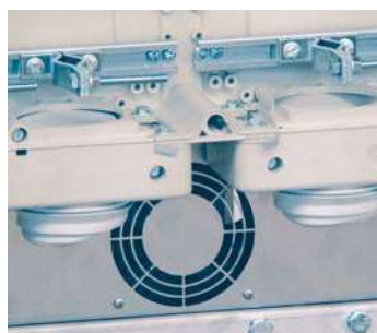
Doppelkabelverschluss mit Kabelschellen, 400V Schaltraum zwangsbelüftet
