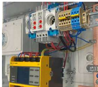
Isolationsüberwachung der 1.000V Strecke, Traforaum zwangsbelüftet
