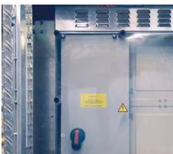
Eingangsseitiger Trennschalter zum Freischalten des Abwärts- trafos
